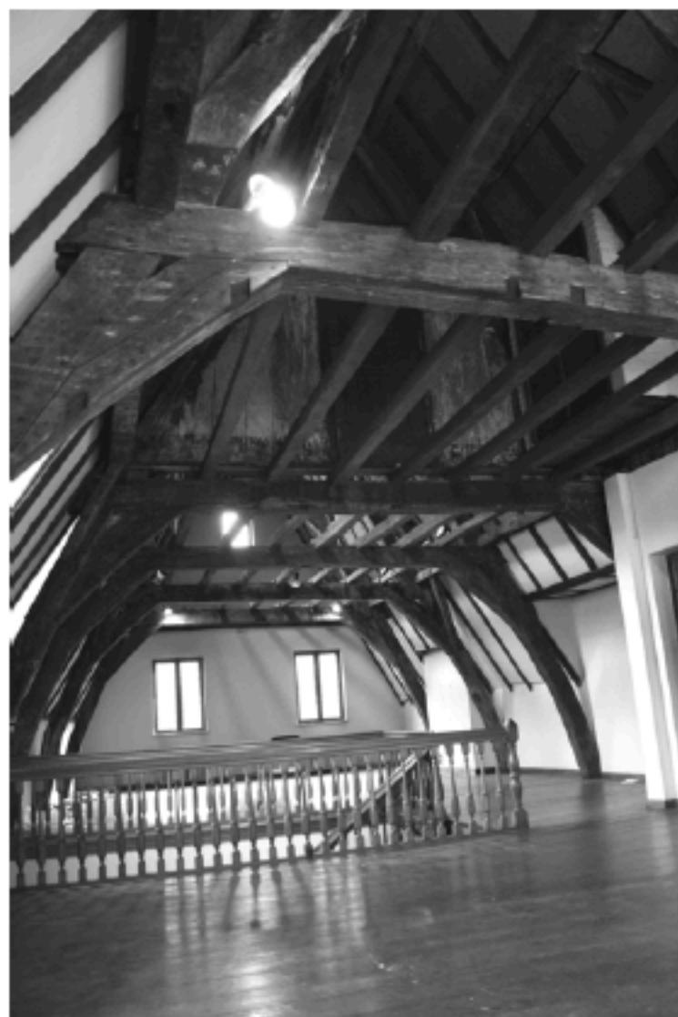
Maison Brueghel, 132 rue Haute à 1000 Bruxelles : vue générale de la charpente à portiques avec la première ferme conservée en avant-plan et portant les marques d'assemblages II (©CReA-Patrimoine).
