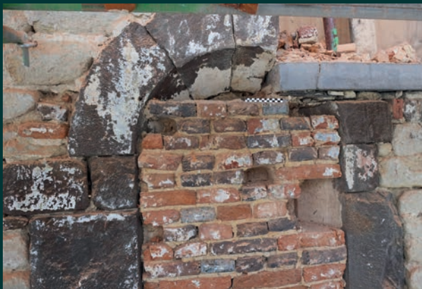
Fenêtre du premier étage perçant le pignon sud de l'aile orientale du cloître, lors des travaux de façade. MRAH – 2014 © Urban.brussels.
